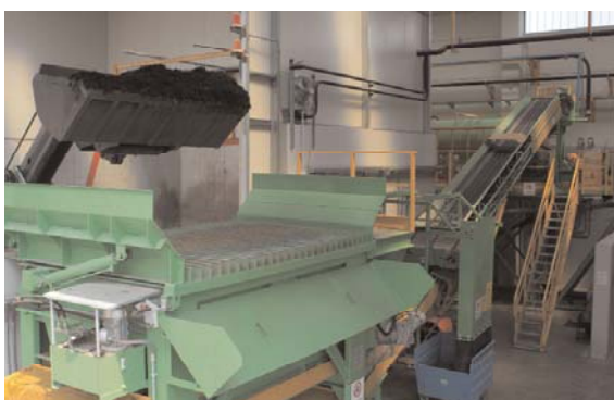
▲ La tramoggia di carico
