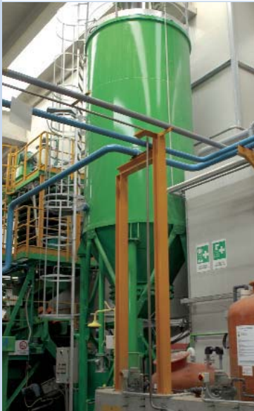
Impianto di lavaggio
